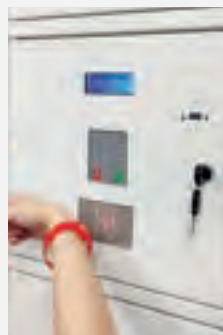
Acesso por pulseira RFID
